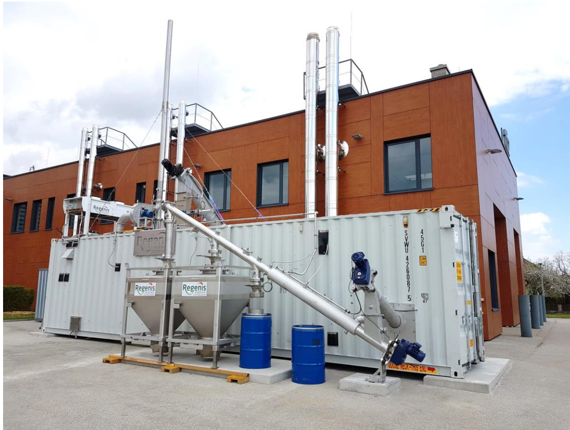
Pyrolyse Wieselburg (AT)
