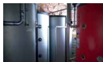
Das Pufferspeichervolumen ist auf vier Behälter aufgeteilt: 900 l für die Wärmepumpe, 3 · 1.000 l für die Pelletkessel.
