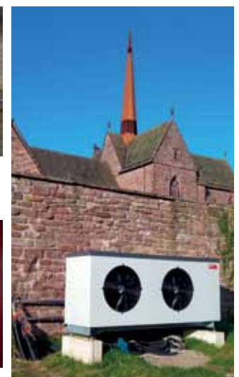
Die Luftwärmepumpe ist an der Südseite der Klostermauer aufgestellt.
